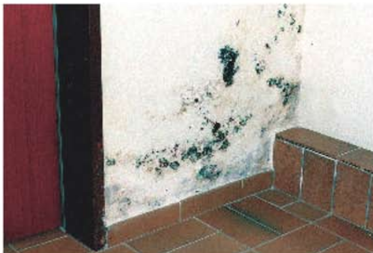
Figura 6 : crecimiento de moho sobre las paredes.
