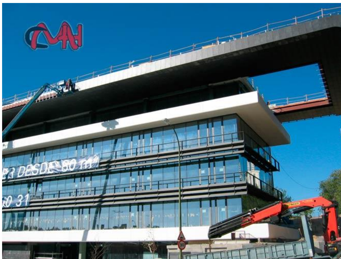
Pasarela Acero Galvanizado en fachada de estructura metálica
